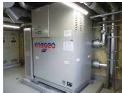
地中熱ヒートポンプ
