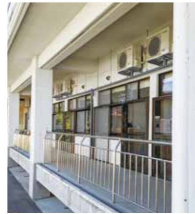
電気式ヒートポンプ
