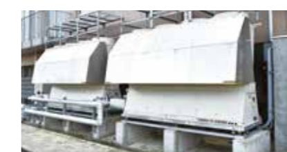
空冷ヒートポンプチラー(千寿苑)
