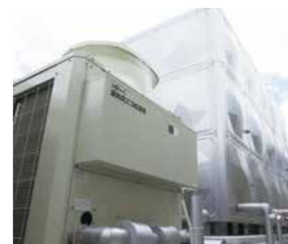
業務用エコキュートと貯湯槽
