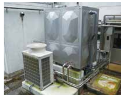
業務用エコキュートと貯湯槽
