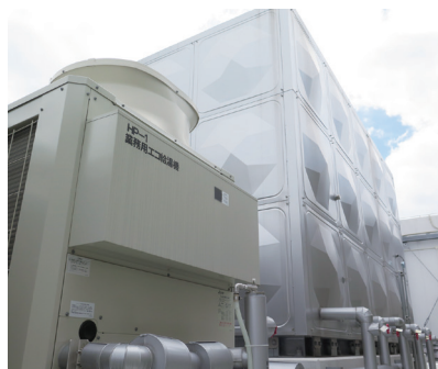
業務用エコキュートと貯湯槽(西条中央病院)
