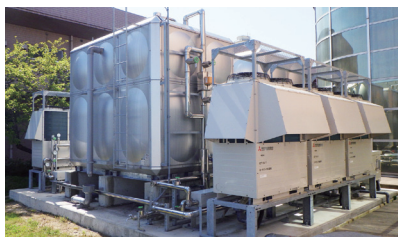
業務用エコキュートと貯湯槽
