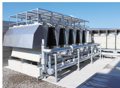
空冷ヒートポンプチラーと直膨エアコン室外機
