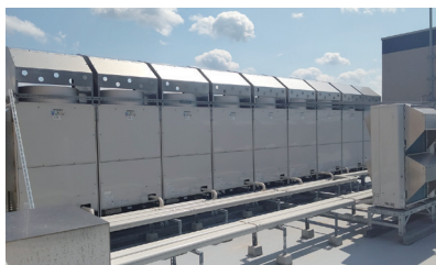
空冷ヒートポンプ
