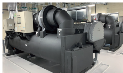
ターボ冷凍機
