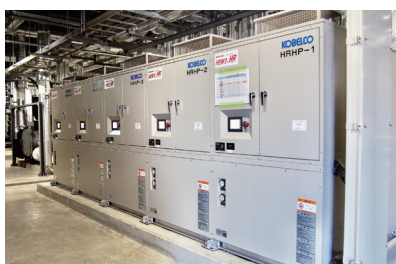
排熱回収ヒートポンプ
