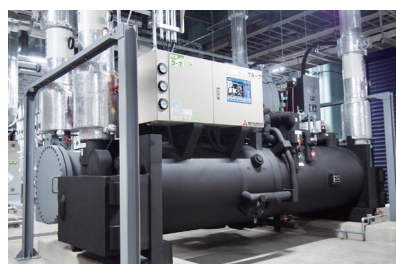
熱回収ターボ冷凍機
