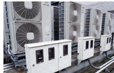
電気式ヒートポンプ
