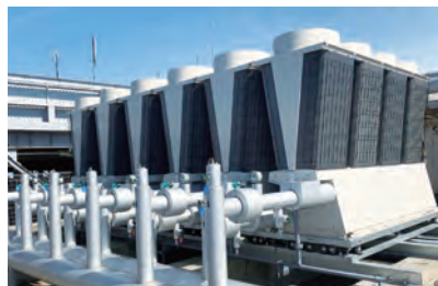
空気熱源ヒートポンプチラー
