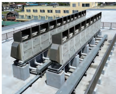
空冷ヒートポンプ
