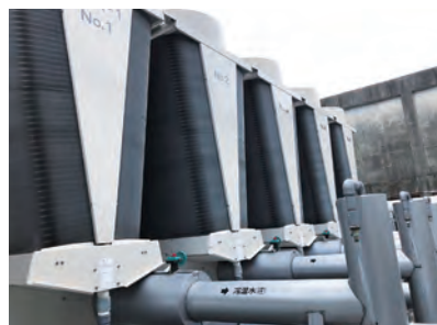
空冷ヒートポンプチャラー
