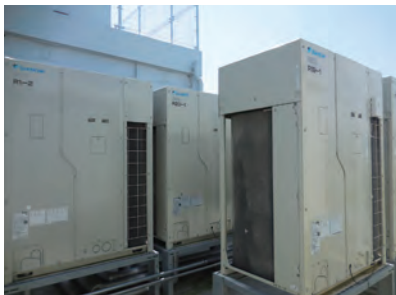
電気式ヒートポンプ
