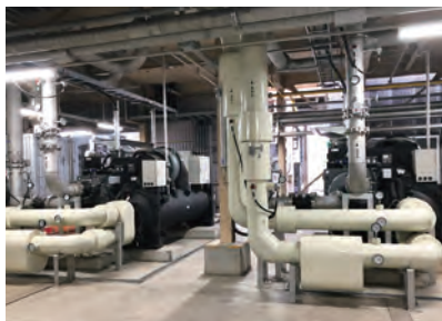
ターボ冷凍機
