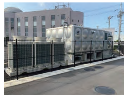
業務用エコキュートと貯湯槽
