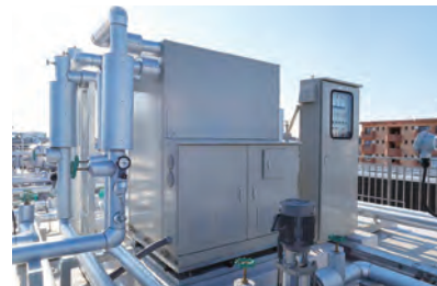
井水利用水冷ヒートポンプチラー
