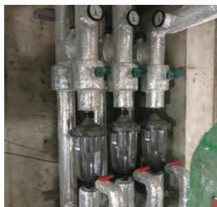
地中熱利用配管に設置された濾過装置
