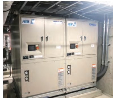
地中熱ヒートポンプ
