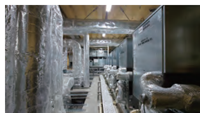
空調設備外観
