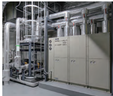
地中熱ヒートポンプチラー
