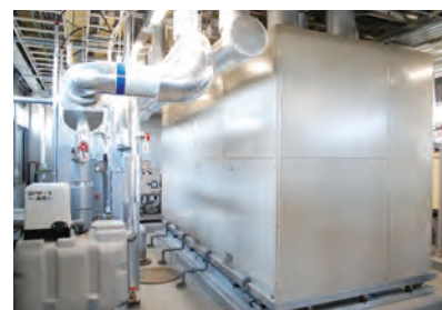
水冷式ヒートポンプチラー
