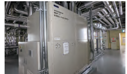
地中熱ヒートポンプチラー
