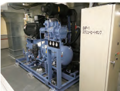
井水ヒートポンプ
