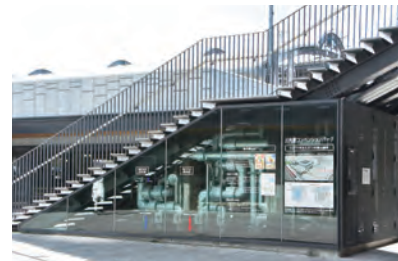
地中熱利用水熱源ヒートポンプ空調機
