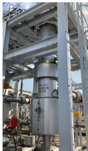
LNGの気化装置
