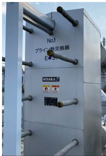
豆腐工場との熱交換部
