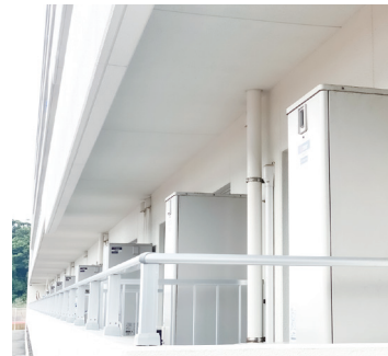
ベランダに設置されたエコキュート
