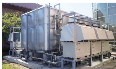
業務用エコキュートと貯湯槽
