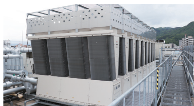
空冷ヒートポンプチャラー
