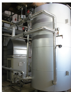
業務用エコキュートと貯湯槽
