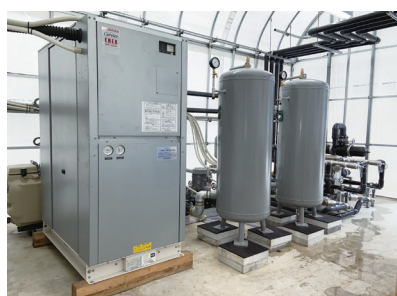
地下水熱ヒートポンプ
