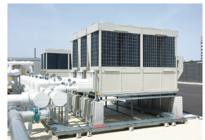
空冷ヒートポンプ
