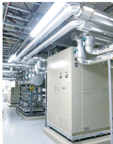
地中熱ヒートポンプ
