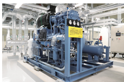
地中熱ヒートポンプ
