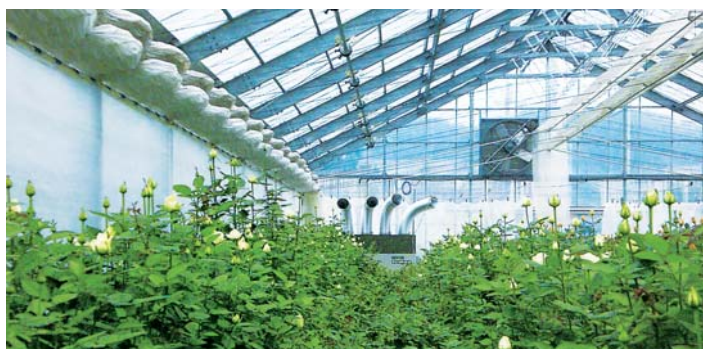
施設園芸用ハウス内（ヒートポンプ設置状況）
