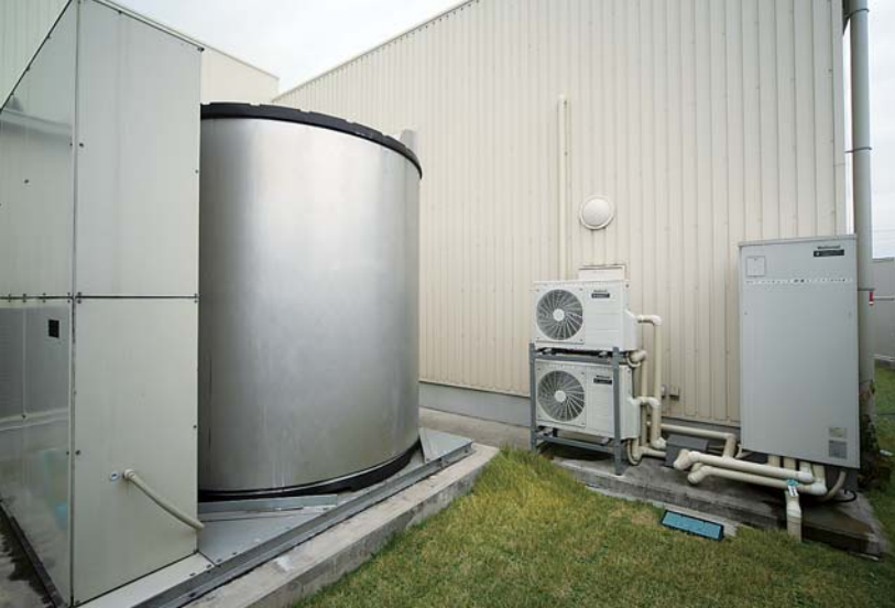
ショーケース用の水蓄熱ユニット(左)とエコキュート
