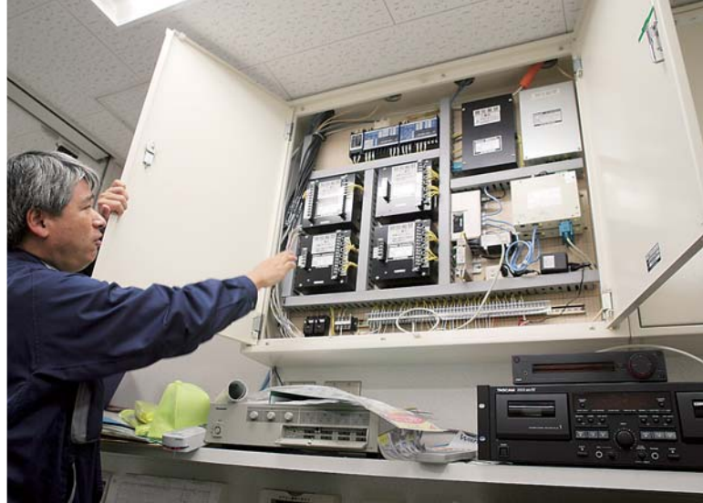
店舗の「エネルギー管理システム」は本社でもモニターできる
