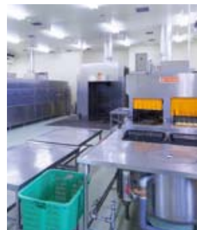
自動洗浄ラインを備えた洗浄室
