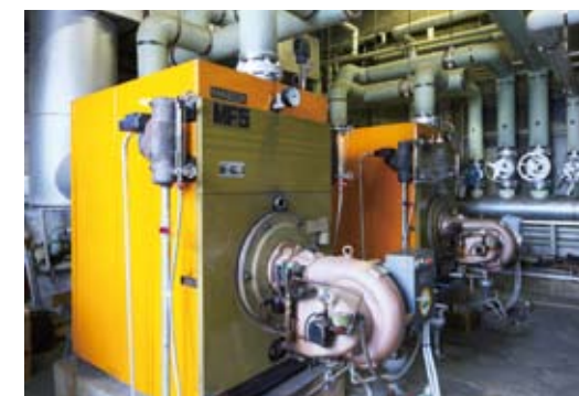
既設のボイラーも有効活用している
