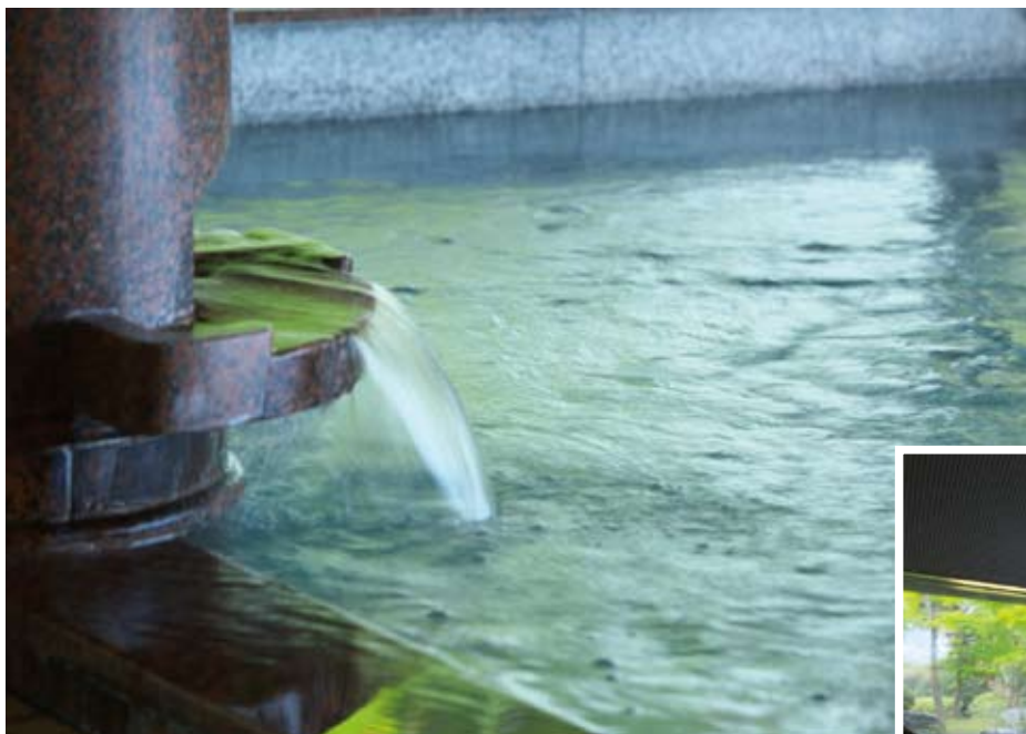
ハイブリッド給湯システムにより、大浴場には常に安定して湯が供給される
