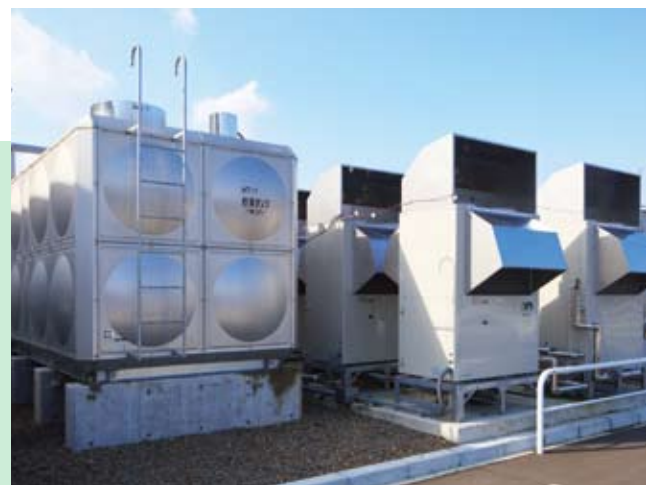
貯湯槽(左)とハイブリッド式エコキュートの熱源機(右)
