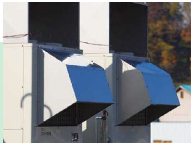
熱源機には防風・防雪フードが付いている
