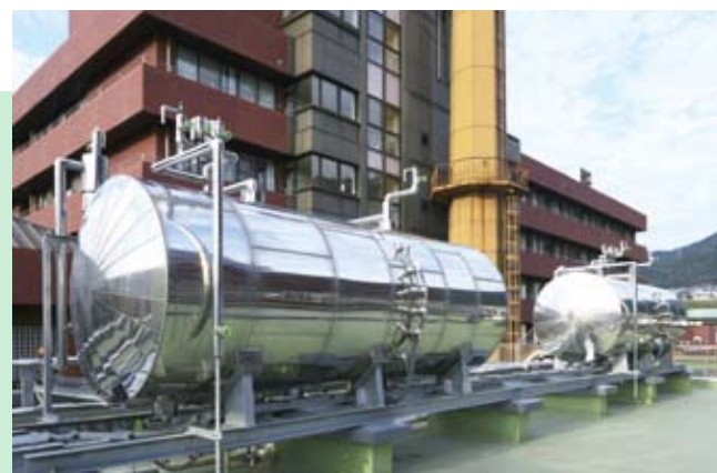
業務用エコキュートの貯湯槽
