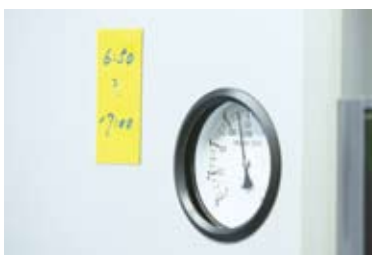
ボイラーの目盛り横に貼られた稼動時間を示すマグネットは、防災センターの省エネルギー提案が採用されたもの
