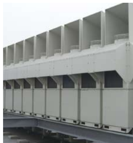
ヒートポンプ室外機
