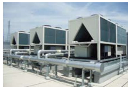
空気熱源ヒートポンプチャラー
