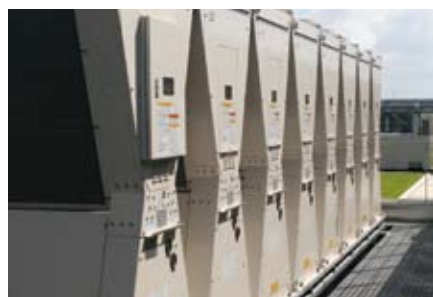
空気熱源ヒートポンプチラー
