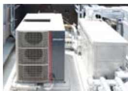
空気熱源ヒートポンプチャラー
