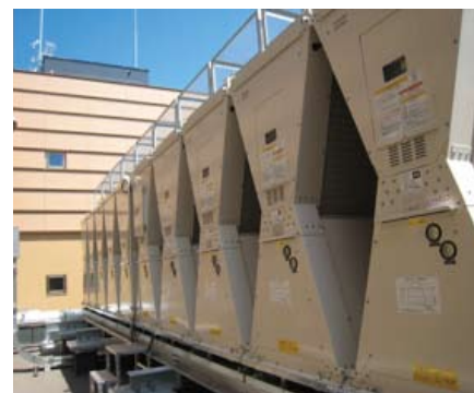
水蓄熱式空調システム(21号館)
