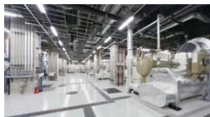
水蓄熱式空調システム（熱源機械室）
