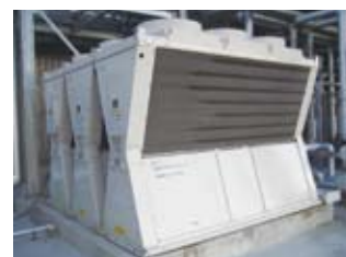
空気熱源ヒートポンプ
