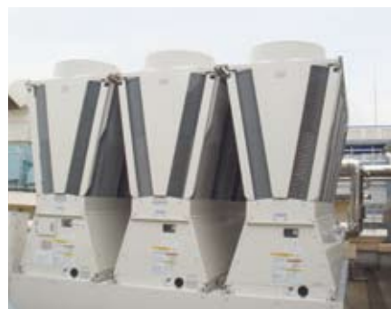
空気熱源ヒートポンプチャラー
