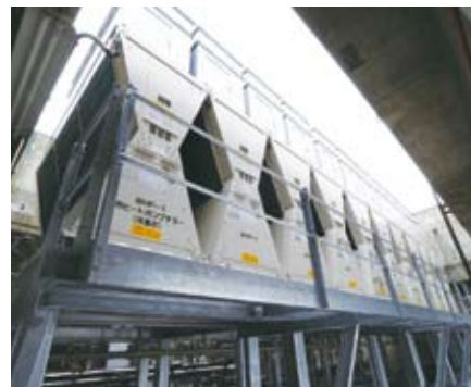
常設展示棟屋上熱源機
