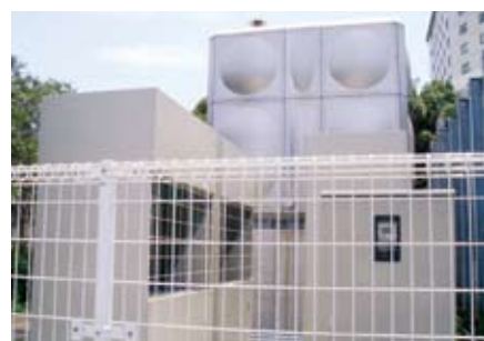
夜間蓄熱用エコキュート(既設)
