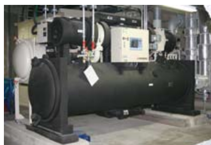
インバータターボ冷凍機
