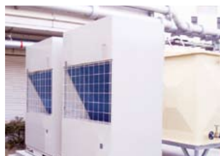
循環加熱用エコキュート(新設)
