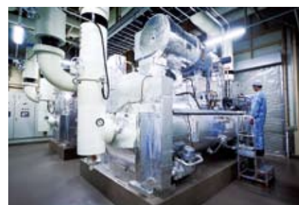
ターボ冷凍機
