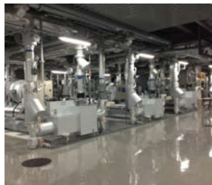
インバーターボ冷凍機
