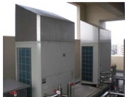
エコキュート (室外機)
