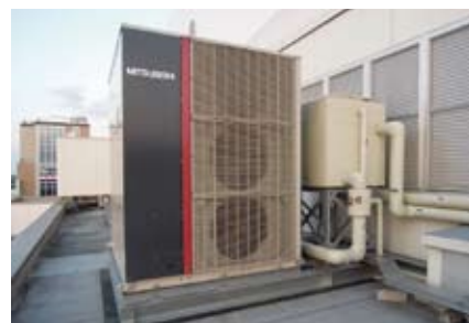
空気熱源ヒートポンプチャラー
