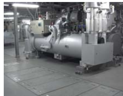
ターボ冷凍機
