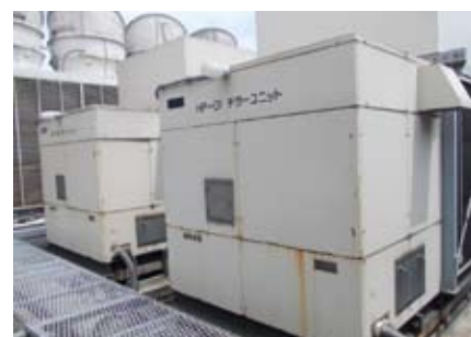
排熱回収ヒートポンプ
