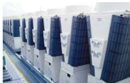
空気熱源ヒートポンプチャラー
