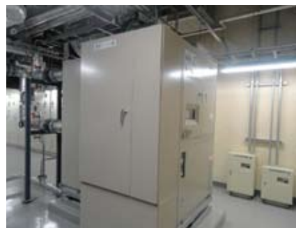
排熱回収ヒートポンプ
