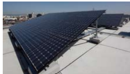
屋上太陽光パネル
