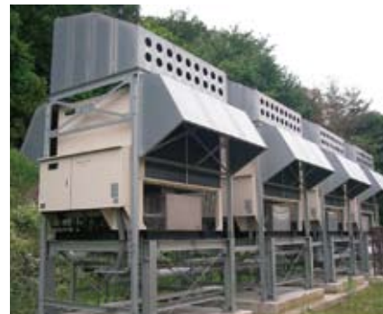
空気熱源ヒートポンプチラー
