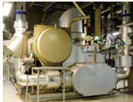
ターボ冷凍機
