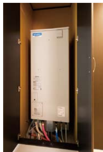
屋内スペースを有効活用し、エコキュートタンクを設置
