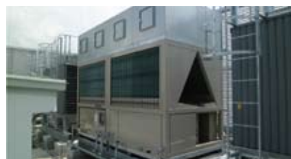
排熱回収ヒートポンプ
