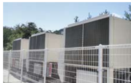
空気熱源ヒートポンプチャラー
