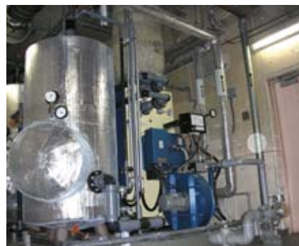
貯湯槽、ボイラ
