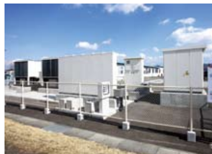
空気熱源ヒートポンプチラー
