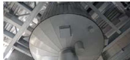
連結縦型蓄熱槽
