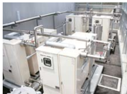
蓄熱式蒸気発生器
