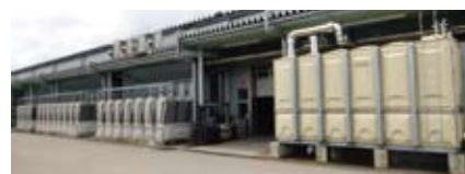
空気熱源ヒートポンプチラー、水蓄熱槽
