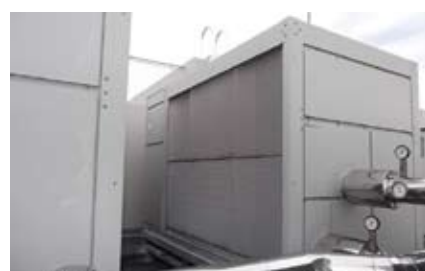
空気熱源ヒートポンプチャラー
