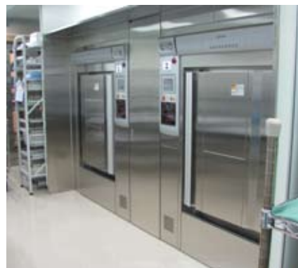
高圧蒸気滅菌装置
