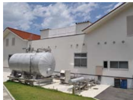
業務用エコキュート(八頭町学校給食共同調理場)
