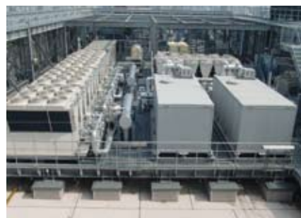
スーパーフレックスモジュールチラー・氷蓄熱槽
