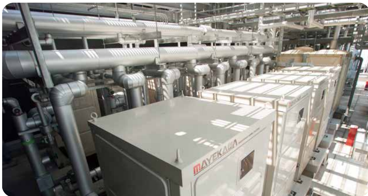
冷温同時取出ヒートポンプ
