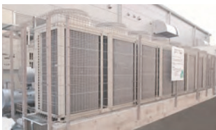
ヒートポンプチラー
