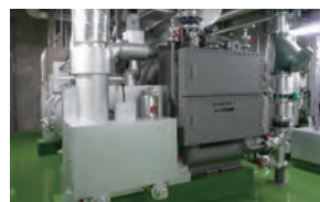
熱回収ターボ冷凍機
