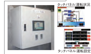
■図3 AHU・チラー制御盤
