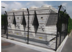
神栖海浜温水プール 空冷ヒートポンプチラー
