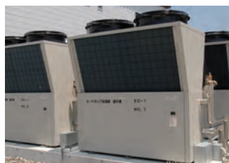
ヒートポンプ給湯器 室外機
