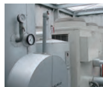
風呂温水クッションタンク
