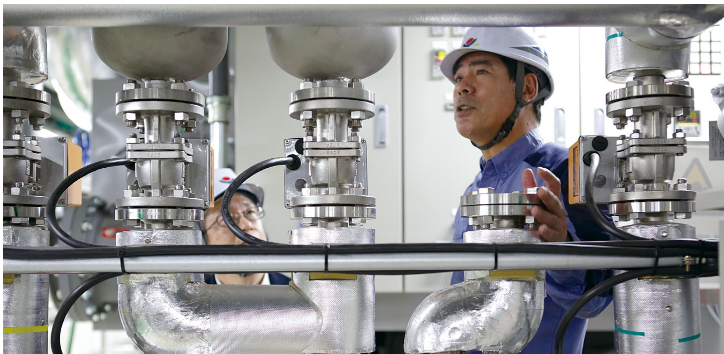
清水所長は変化する河川の状況を的確に判断しながらヒートポンプの運用を行っている
