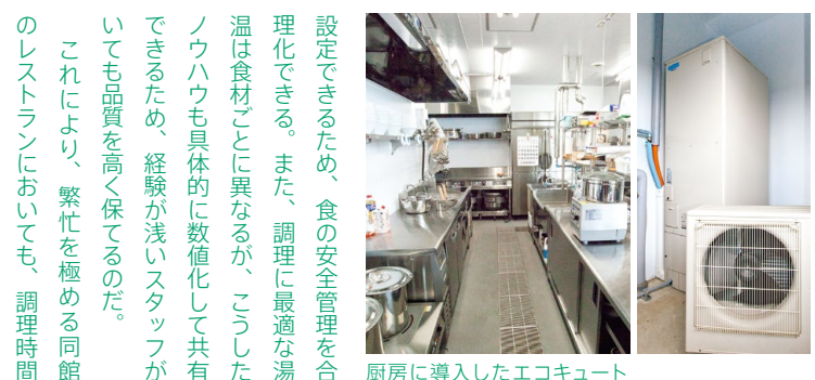
厨房に導入したエコキュート
