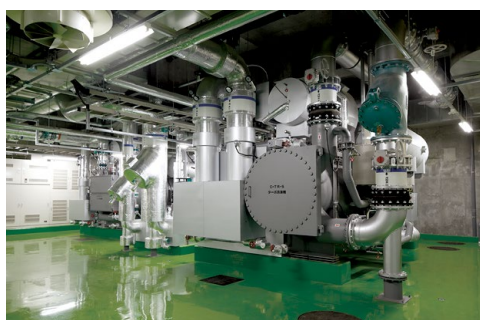
ターボ冷凍機は計4基を導入している
