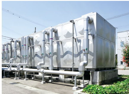
2 基の水蓄熱槽を設置
