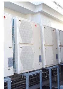
ヒートポンプ式の ロードヒーティング
