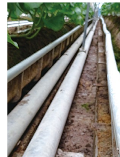
土の上の配管に温水を供給
