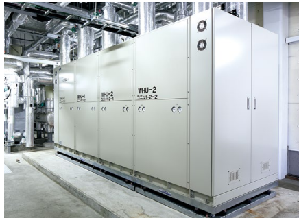
地中熱利用ヒートポンプ 8 台を運用
