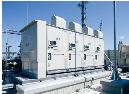
水冷ヒートポンプチラーは計4台を導入
