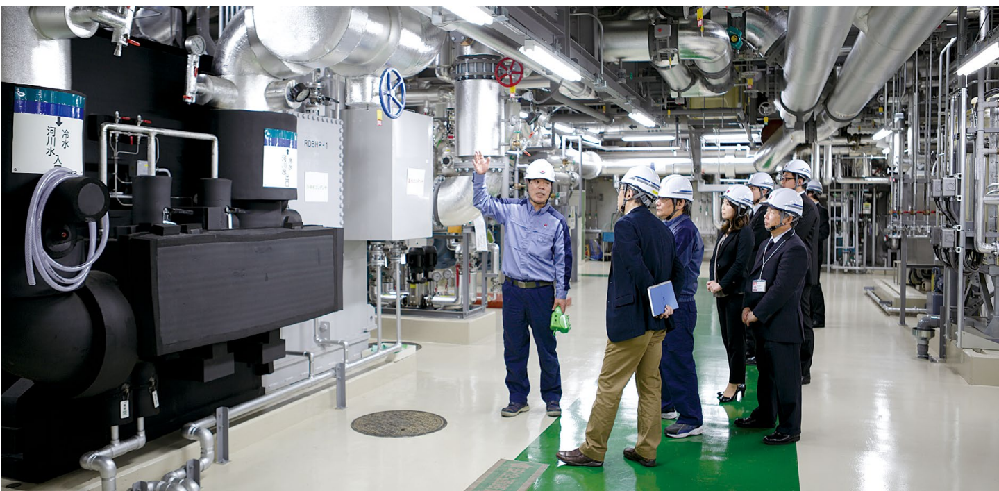
リニューアル工事完了後、システムCOP15%向上を実現した河川水を利用したヒートポンプ
