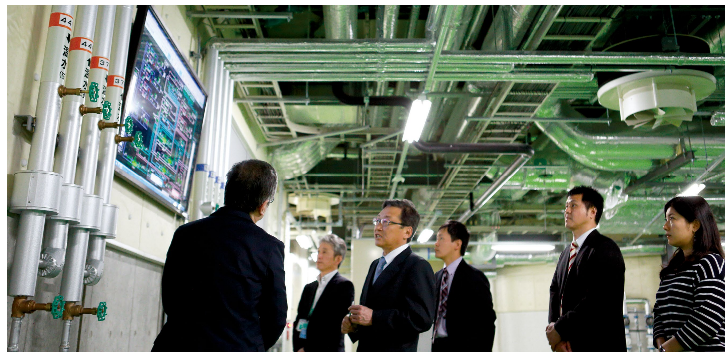
BEMSを採用することで、ビル全体やフロアごとのエネルギーの使用量を把握することができる
