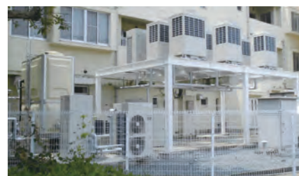
あゆみの里B棟 室外機
