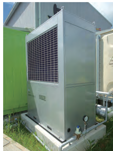
冷温同時取出ヒートポンプ
