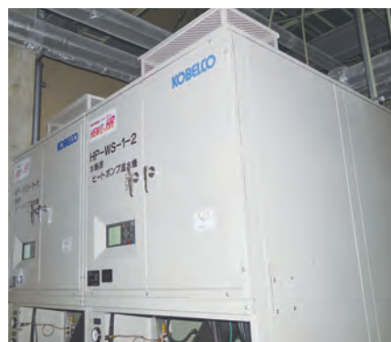
冷温同時取出ヒートポンプ
