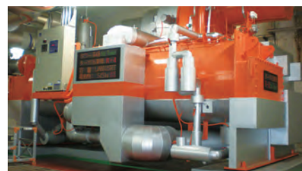
ターボ冷凍機
