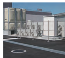
業務用ヒートポンプ全景
