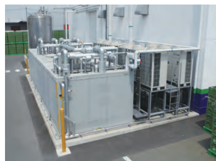
氷蓄熱槽および熱源機
