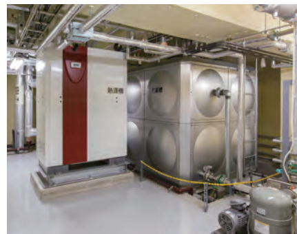
地中熱ヒートポンプ・業務用エコキュート貯湯槽
