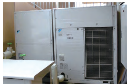
なごみの里 業務用ヒートポンプ給湯機
