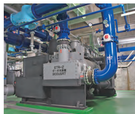
ターボ冷凍機
