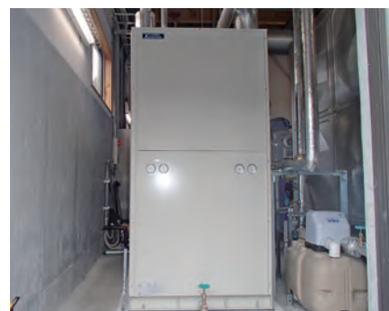
排熱回収給湯用ヒートポンプ
