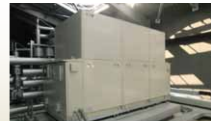
井水熱源ヒートポンプ
