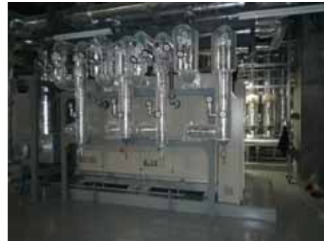
ヒーティングタワーヒートポンプ
