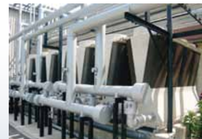
空気熱源ヒートポンプチャラー
