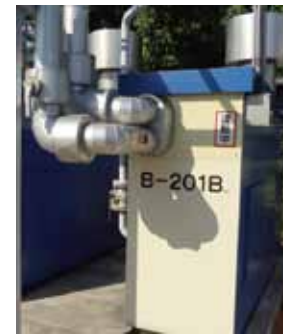
既設温水ヒータ
