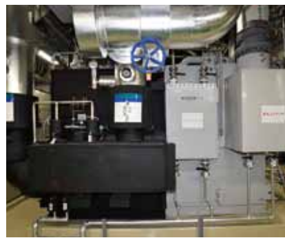
排熱回収ヒートポンプ
