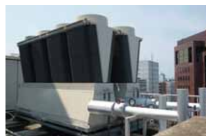
空気熱源ヒートポンプチャラー
