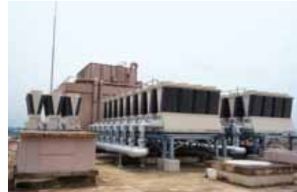
空気熱源ヒートポンプチャラー
