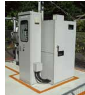
排熱回収ヒートポンプ(追設)
