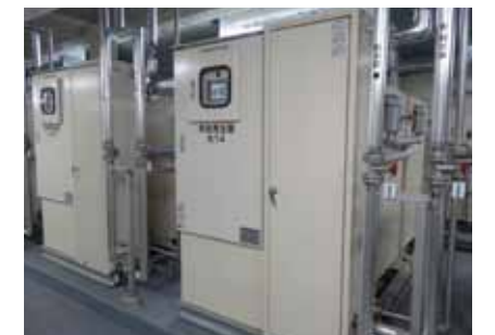
電気式簡易ボイラー
