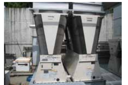
循環加温ヒートポンプ
