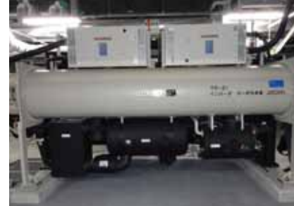
ターボ冷凍機
