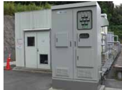
空冷ヒートポンプ
