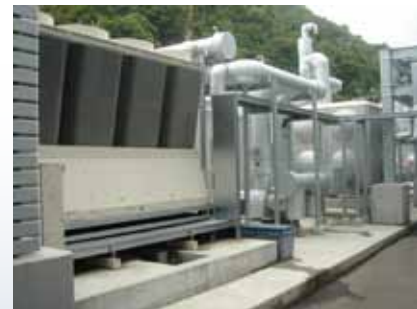
空気熱源ヒートポンプチャラー
