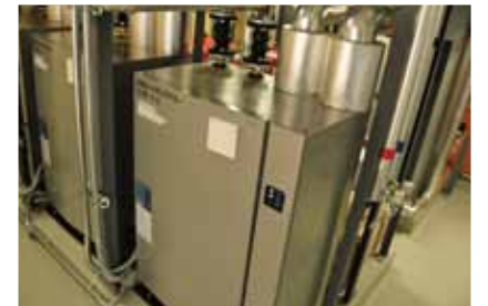
地中熱源ヒートポンプチラー
