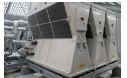
空気熱源ヒートポンプチャラー
