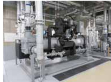
ターボ冷凍機
