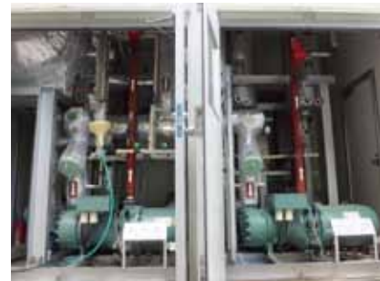
ヒートポンプユニット
