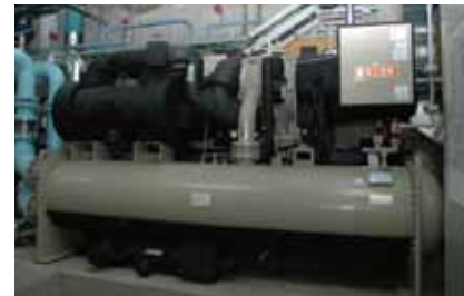
ターボ冷凍機
