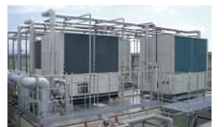
空気熱源ヒートポンプチラー
