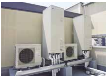
エコキュート設備
