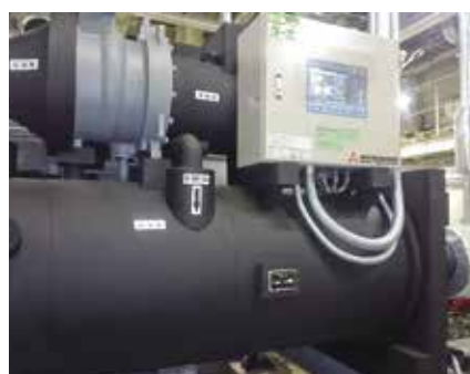
ターボ冷凍機
