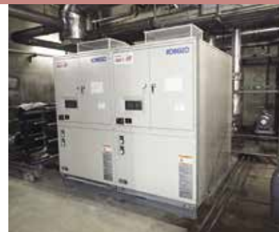
排熱回収ヒートポンプ
