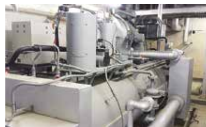
ターボ冷凍機
