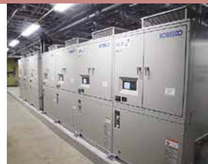
導入した水冷ヒートポンプチラー
