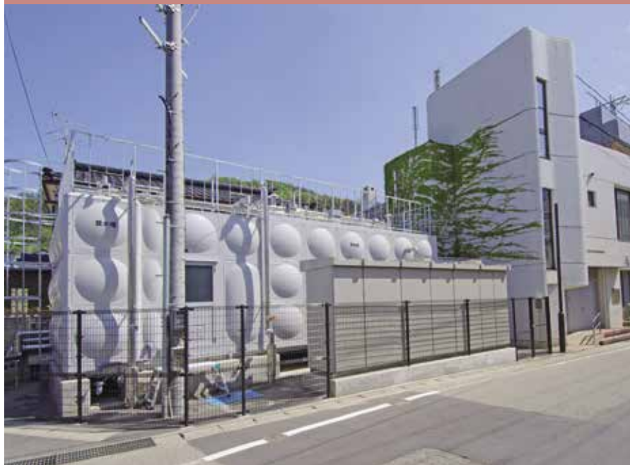
集中給湯設備外観
