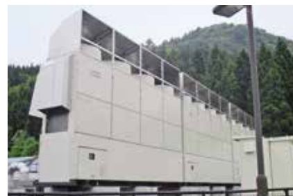
東蒲の里みかわ園 室外機
