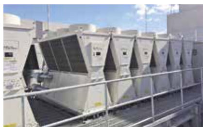
空冷ヒートポンプ(屋上)
