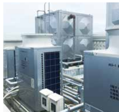
業務用エコキュートと貯湯槽
