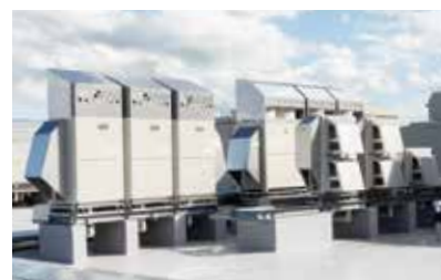
電気式ヒートポンプ
