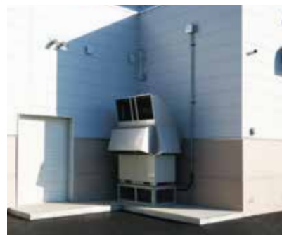
業務用エコキュート室外機
