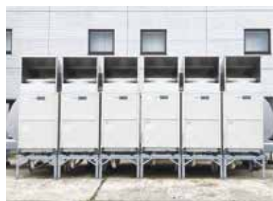
電気式ヒートポンプ
