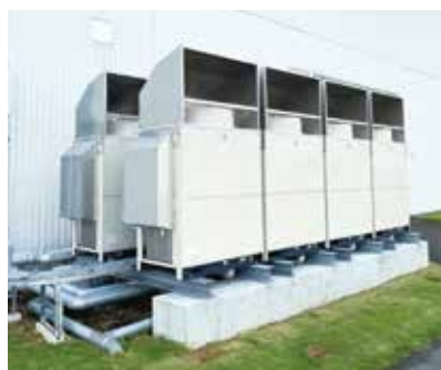
電気式ヒートポンプ
