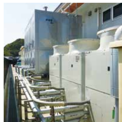
業務用エコキュートと貯湯槽
