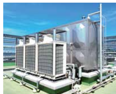
業務用エコキュートと貯湯槽
