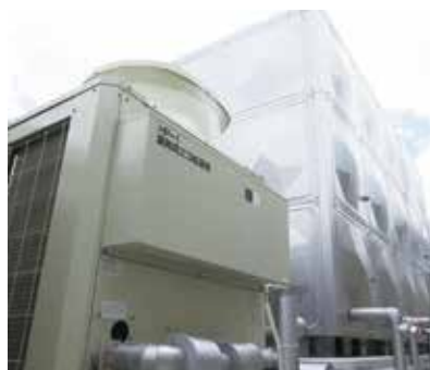
業務用エコキュートと貯湯槽
