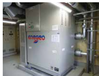
地中熱ヒートポンプ
