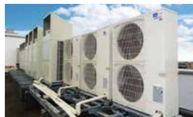
電気式ヒートポンプ
