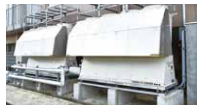
空冷ヒートポンプチラー(千寿苑)
