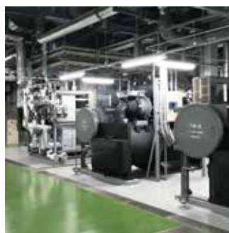
インバーターボ冷凍機
