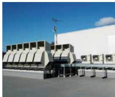
電気式ヒートポンプ
