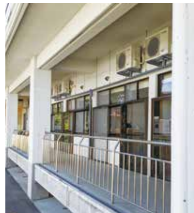
電気式ヒートポンプ
