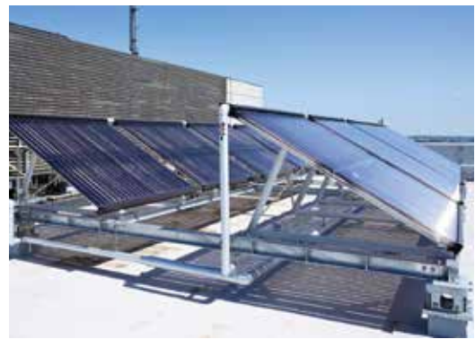
太陽熱集熱パネル
