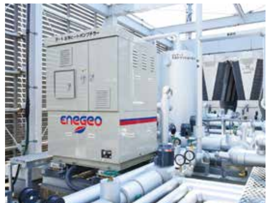
地中熱利用水冷式ヒートポンプ
