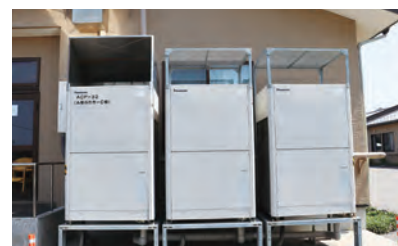
空冷ヒートポンプ
