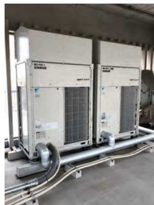
熱源ユニット(室外機)
