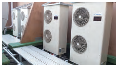
業務用エコキュート室外機
