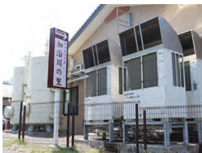
業務用エコキュートと貯湯槽
