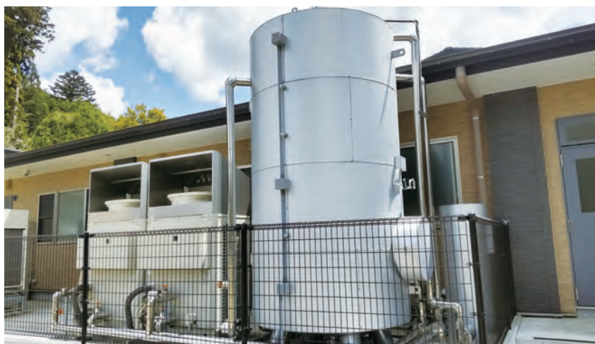
業務用エコキュートと貯湯槽
