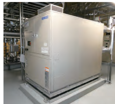
地中熱利用ヒートポンプチャラー
