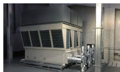
空気熱源ヒートポンプチラー
