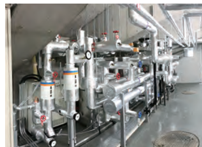
水冷ヒートポンプ（地中熱利用）
