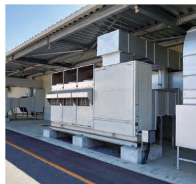
電気式ヒートポンプ
