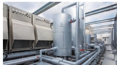
業務用エコキュートと貯湯槽
