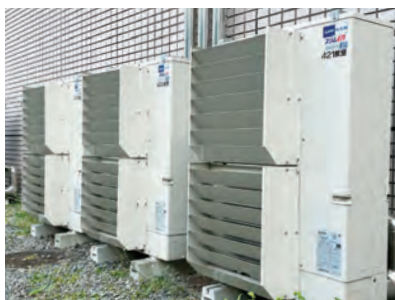
冷暖ビルマルパッケージエアコン室外機
