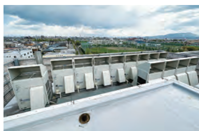
電気式ヒートポンプ空調
