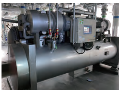
ターボ冷凍機
