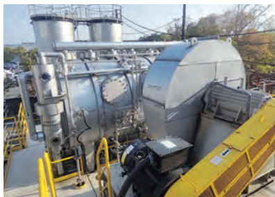
排熱利用ヒートポンプ
