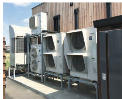
空冷ヒートポンプ
