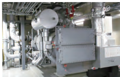
ターボ冷凍機
