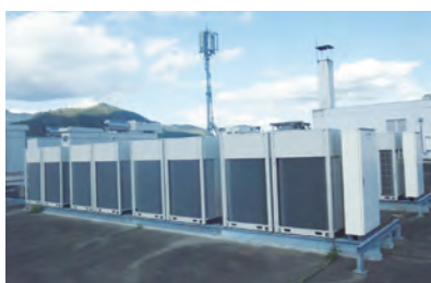
空気熱源ヒートポンプチャラー
