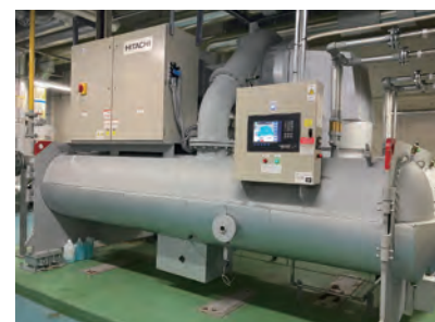
ターボ冷凍機
