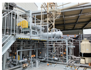
ヒートポンプ式蒸発濃縮装置
