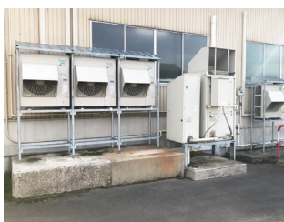
エアコン室外機
