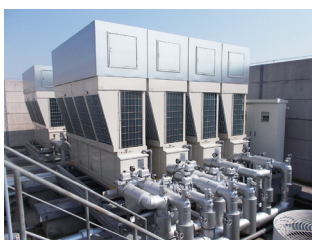
ヒートポンプチラー
