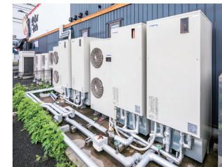
業務用エコキュートと貯湯槽
