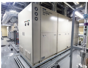
地中熱利用ヒートポンプチャラー
