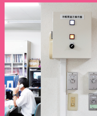
事務所内に設置された 空調コントロールパネル
