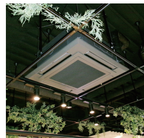
マルチエアコン室内機
