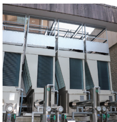
空冷式ヒートポンプチャラー
