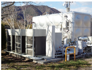
ヒートポンプ給湯器(手前)と貯湯槽
