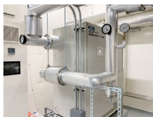
地中熱利用ヒートポンプ
