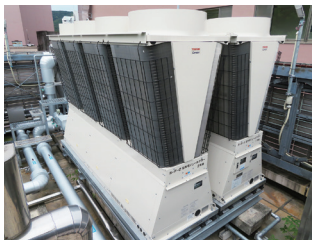
ヒートポンプチラー
