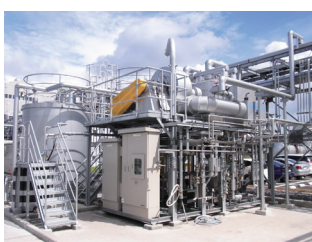
ヒートポンプ式蒸発濃縮装置
