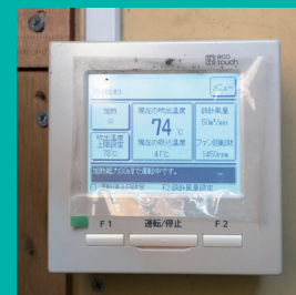
温度調節を行う コントロールパネル
