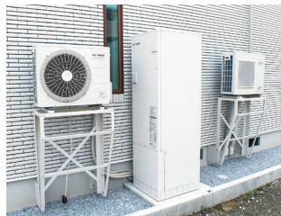
耐水害仕様では機器の水没にも配慮
