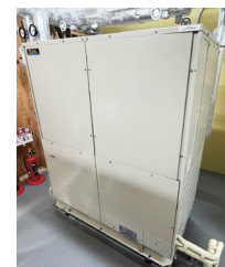
地中熱利用ヒートポンプ
