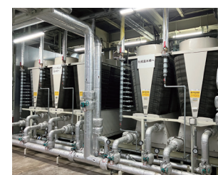
空冷式ヒートポンプチラー
