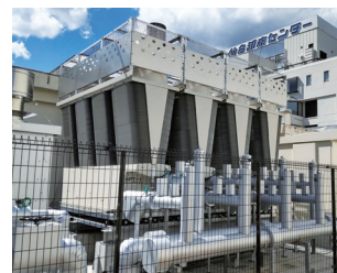
空冷式ヒートポンプチラー
