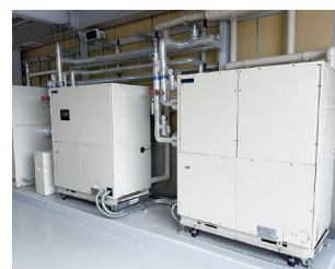
地中熱ヒートポンプ本体
