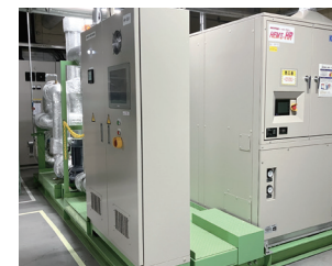
高温ヒートポンプチラー
