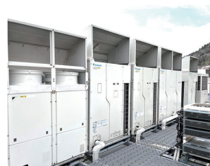
空冷ヒートポンプ室外機
