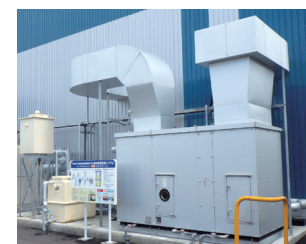
地中熱空調システム機器
