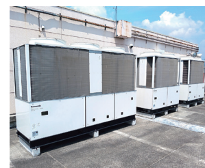
空冷ヒートポンプ冷凍機
