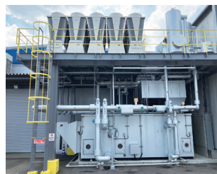
空冷式ヒートポンプシステム
