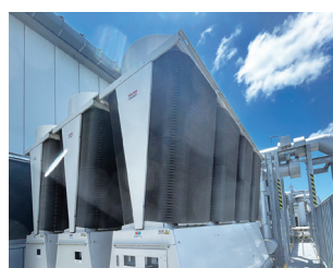
空冷式ヒートポンプチラー
