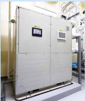
地中熱ビルマルチエアコン 室内ユニット
