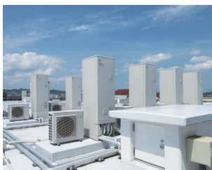
エコキュート貯湯タンク
