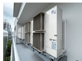
ヒートポンプエアコン室外機
