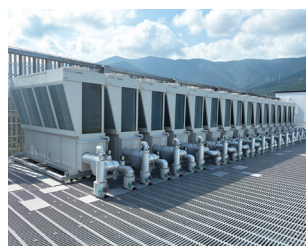
空冷式ヒートポンプ(モジュールチラー)
