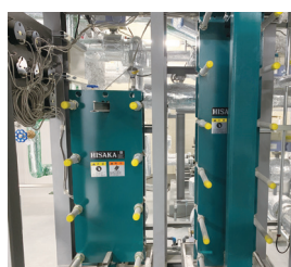
蓄熱槽熱交換機
