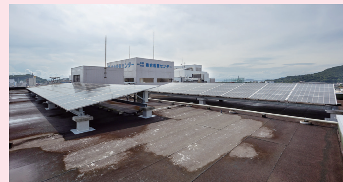
病院本館（東館）屋上に設置された太陽光発電パネル
