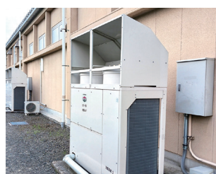
空冷ヒートポンプ室外機
