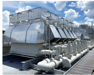
空冷式ヒートポンプチラー
