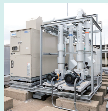
屋上に設置された排熱回収ヒートポンプ。
