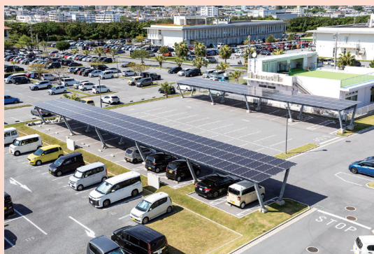
駐車場の屋根に敷き詰められた太陽光発電パネル
