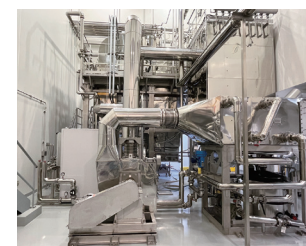
熱風ヒートポンプ設備
