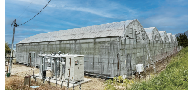
みかんの栽培ハウスと地中熱利用ヒートポンプ
