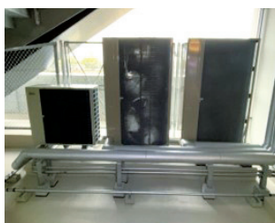
屋外機設置状況
