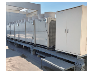
空冷式ヒートポンプチラー
