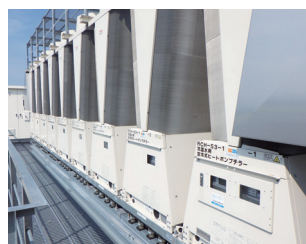
空冷式ヒートポンプチラー
