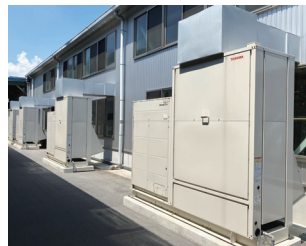
外気処理エアコン室外機
