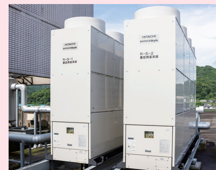
病院本館（東館）屋上に設置された 空冷式ヒートポンプチラー
