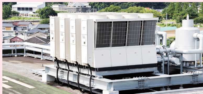
西館屋上に設置された空冷式ヒートポンプチラー
