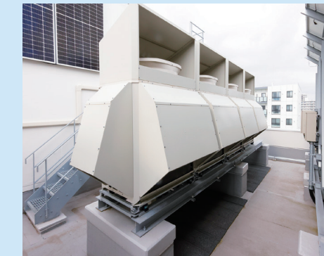
屋上に設置された空冷式ヒートポンプチラー
