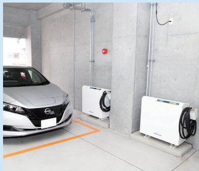
車庫に電気自動車の充電器「V2H」を設置。太陽光で発電した電気で充電している。
